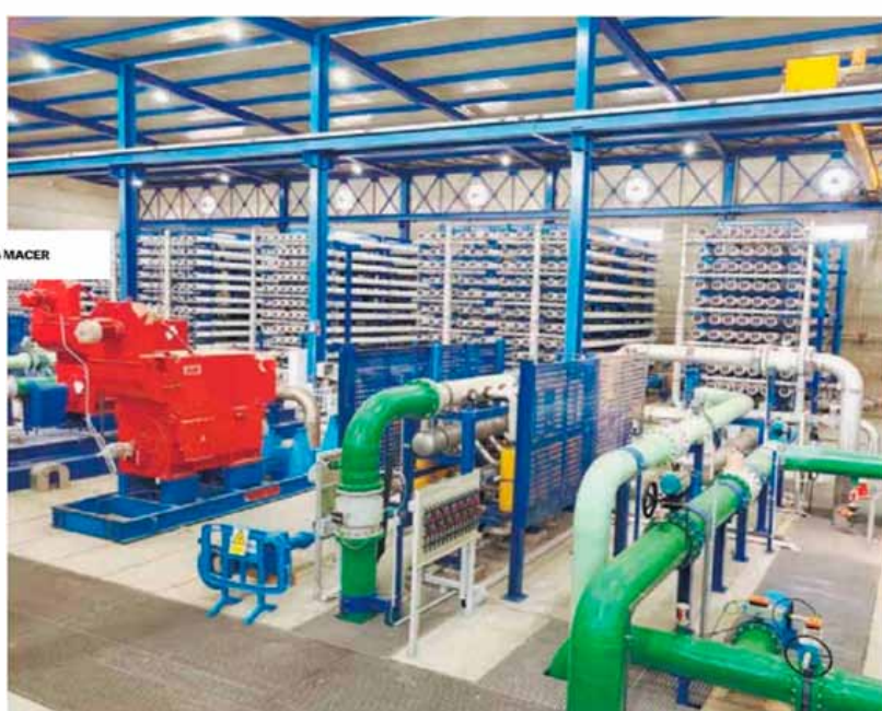
Las espectaculares instalaciones de la desaladora Mar de Alborán, en Cabo de Gata, que ya se encuentran dando servicio.
