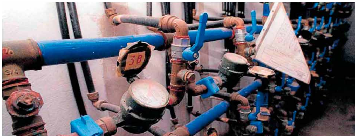
Imagen de archivo de contadores del agua. cz
