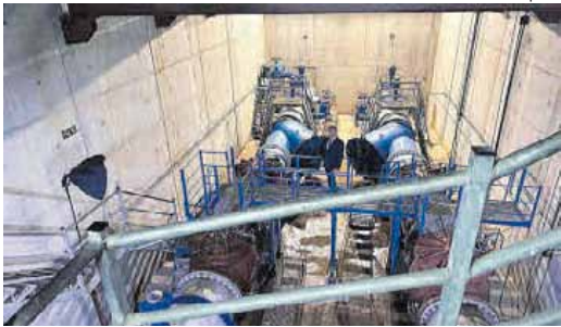
Instalaciones del sistema de abastecimiento de agua de Zaragoza.
