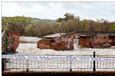
El puente derrumbado por la crecida en Talavera. MANU REINO / EFE
